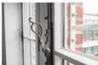
Die Fenstergriffe gehören zu den erhaltenen Details aus der Bauzeit. Foto: Stadt Herne/ Schmidt
